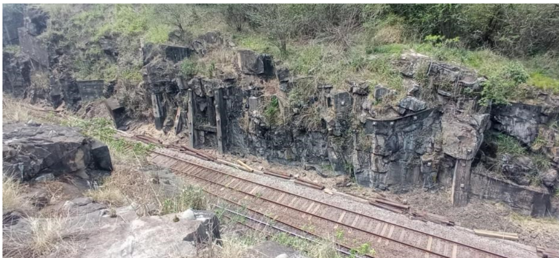
Figura 6 - Estreitamento de Passagem - Recorte de Morro (Ponto 57/MRS), em Japeri
